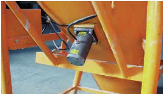
Austragshilfe am Behälter
